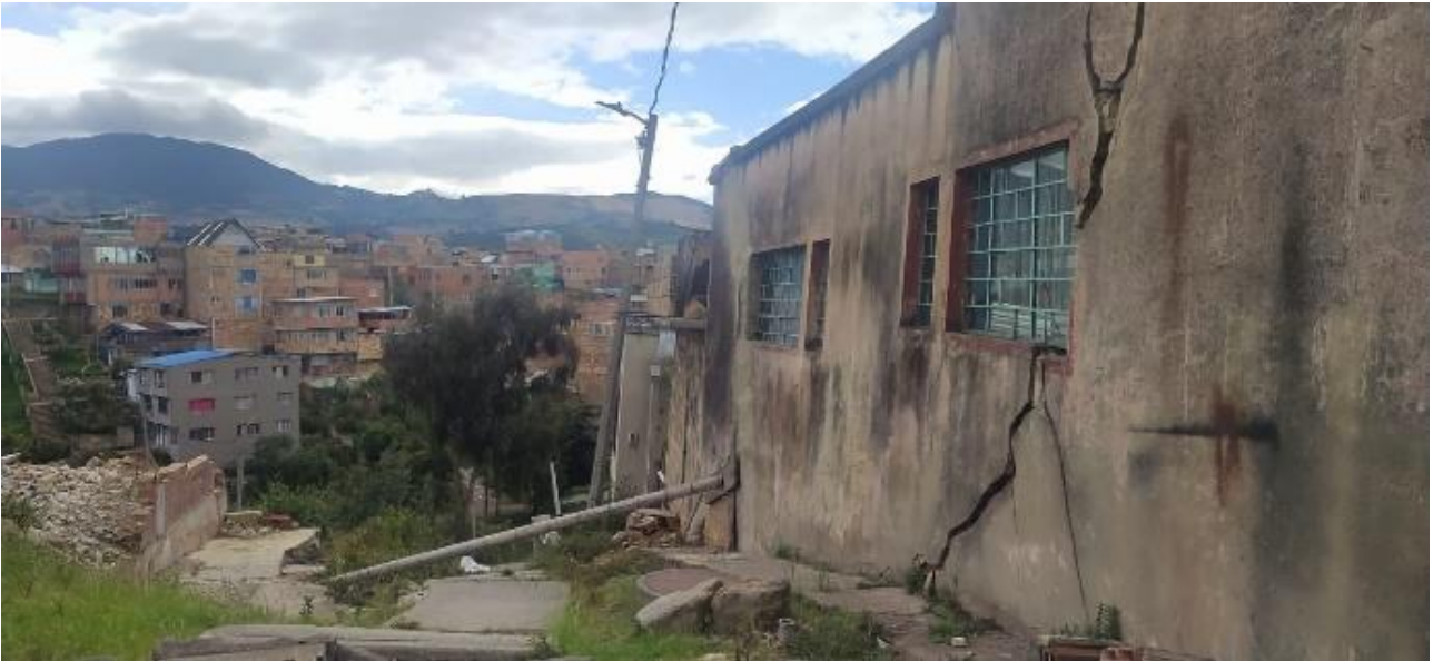
Ilustración 2: Casa con grietas e infraestructura eléctrica colapsada
